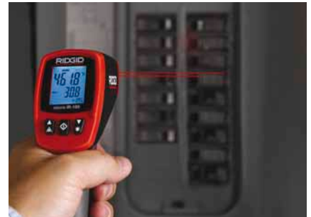
Aşırı yüklenmiş devrelerden kaynaklanabilecek aşırı ısınmış sigorta veya devre kesicilerin kontrolünü yapın.
